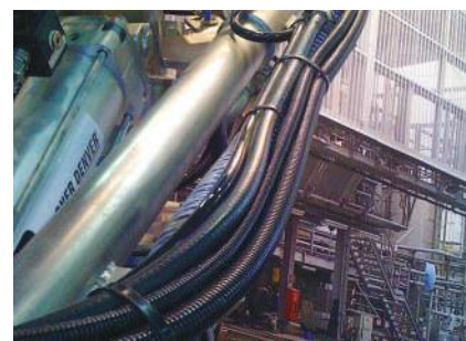
Impianti industriali Industrial plants
